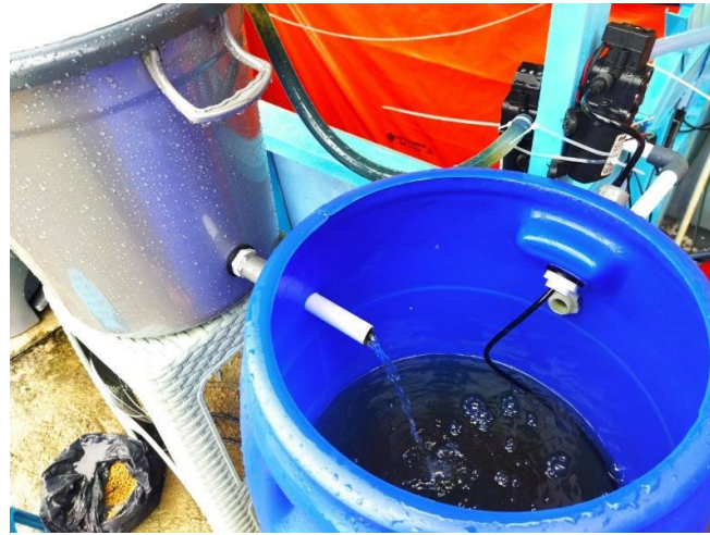
Gambar 15. Bak Penampungan Air
